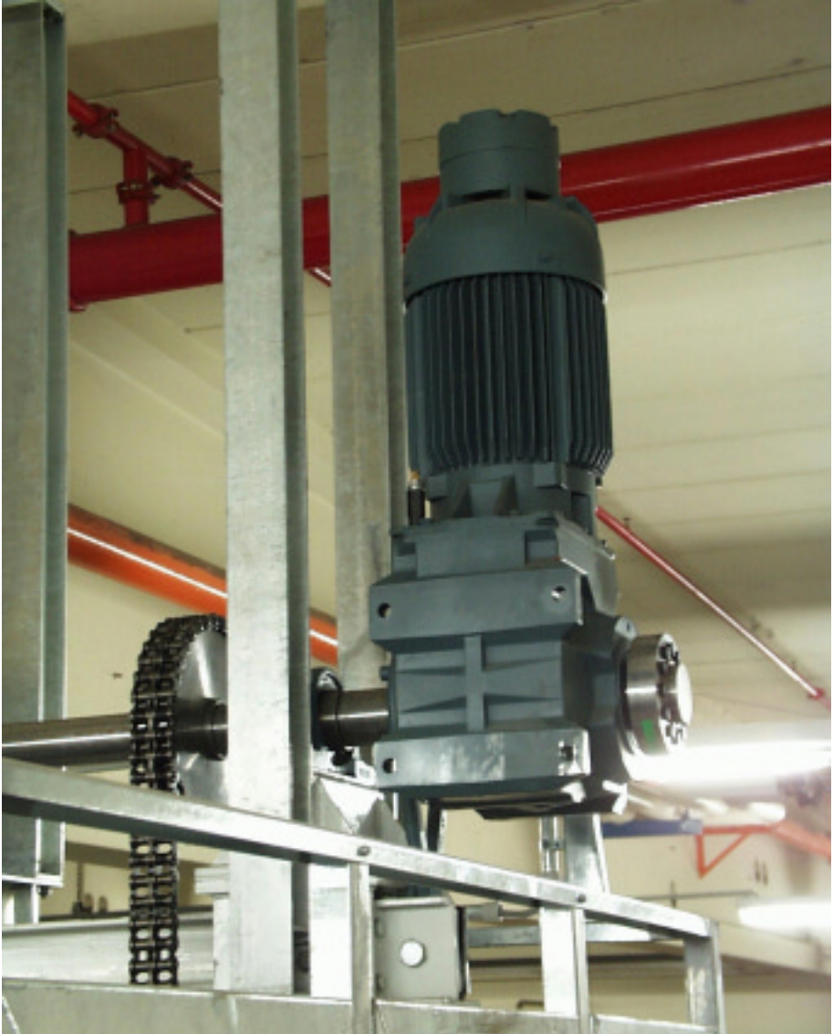
Bild 19.2 Heberantrieb in einer Automobilfabrik, angetrieben durch Getriebemotor. Kegelrad-Getriebe in Aufsteckform; Abwärtsbetrieb als übersynchrone Generator am Netz
