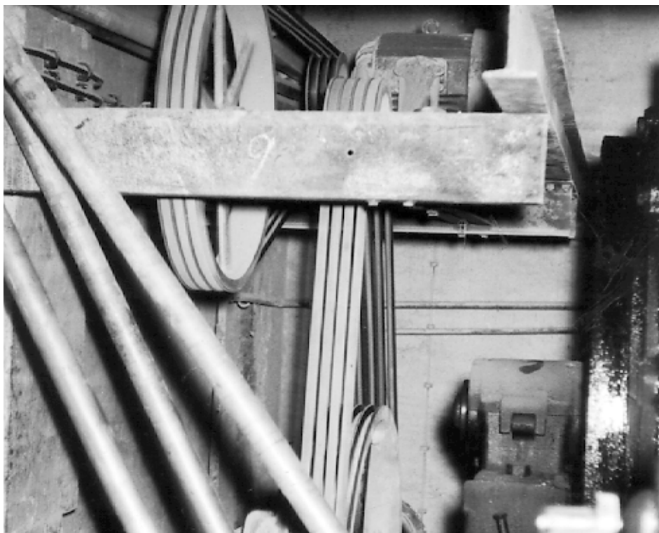
Bild 1.2 Indirekter Antrieb einer Trommel-Nassmühle in einem Keramikwerk mit Normalmotor und zweifacher Keilriemenuntersetzung
