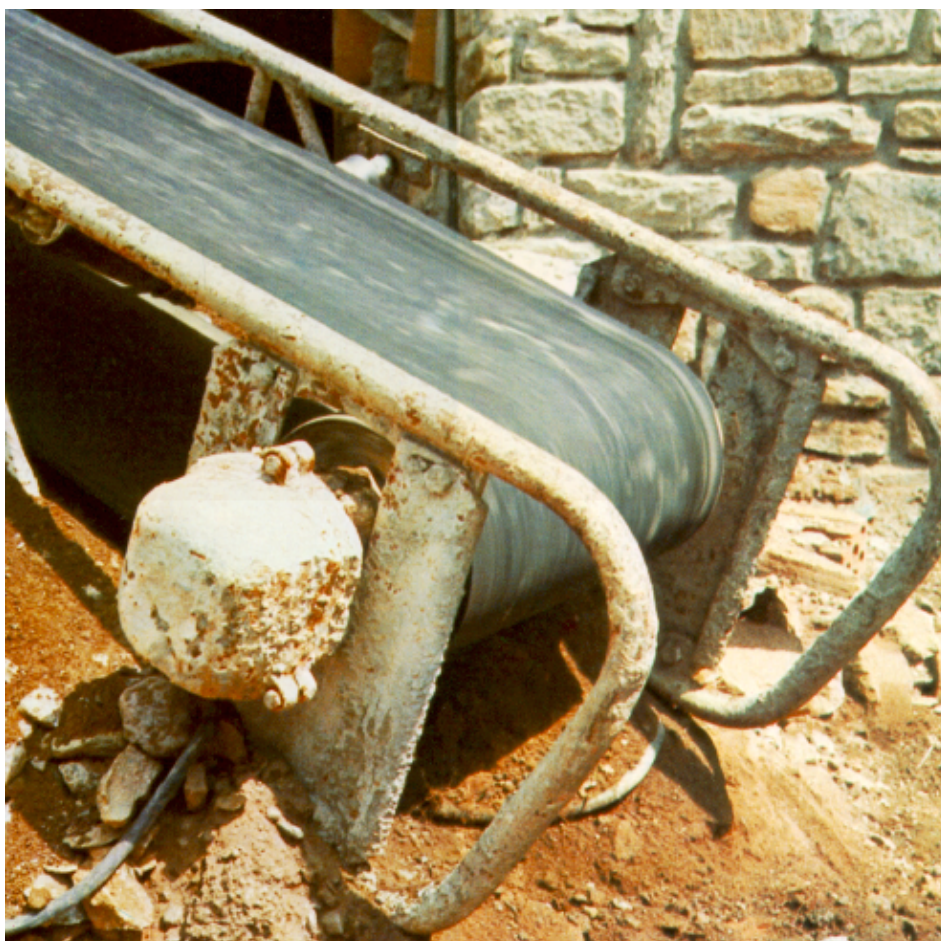
Bild 19.4.2 Äusserlich angegriffener, aber voll funktionstüchtiger Trommelmotor an einem tragbaren Gurtförderer im harten Baustelleinsatz
