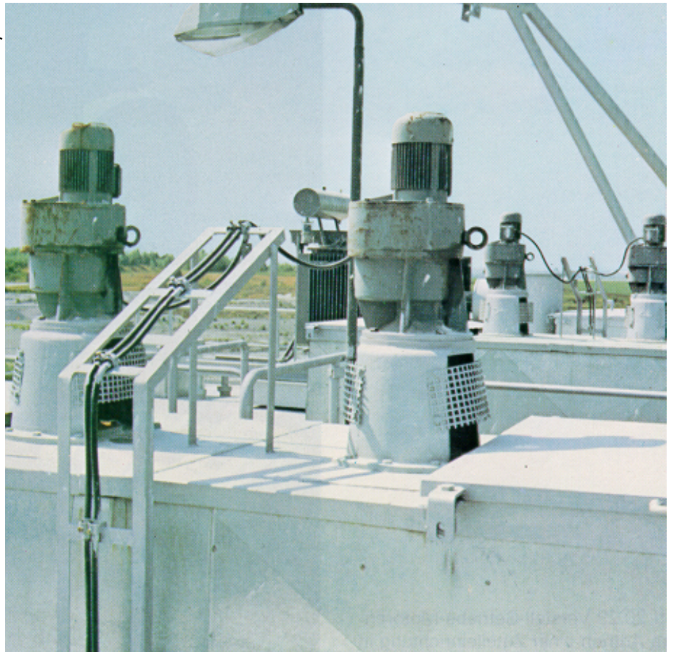
Bild 26.25 Klopfwerke für die Staubfilter in einem Zementwerk; Aufstellung im Freien.
