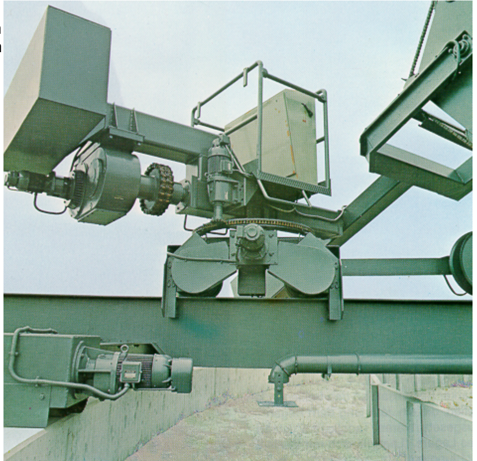
Bild 26.8 Drehstrom-Getriebe-Motoren verschiedener Bauformen an einem Kläranlagen- Schrapper.
