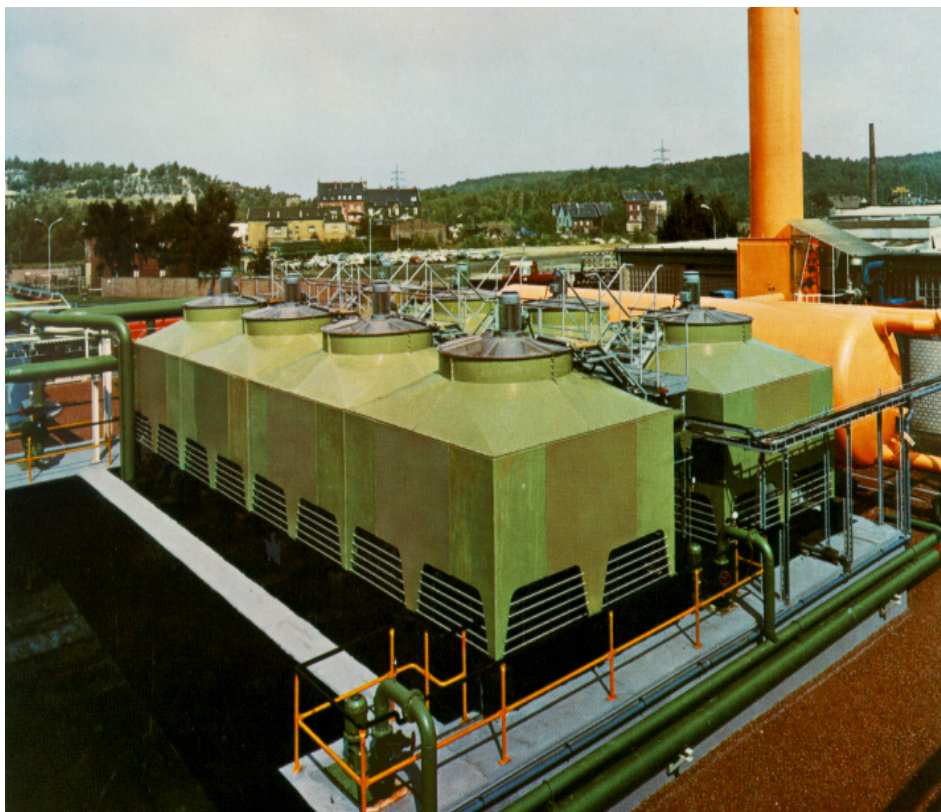
Bild 19.4.1 Drehstrom-Getriebe-Motoren in Sonderschutzart IP66 mit erhöhtem Korrosionsschutz CORO 3 zum Antrieb einer Gruppe von Kühlturm- Ventilatoren.
