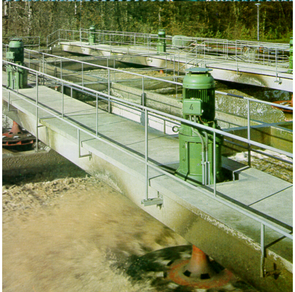
Bild 26.28 Belüftungsrotoren in einem Klärwerk mit Getriebe- Motoren in Aufstellung V1.
