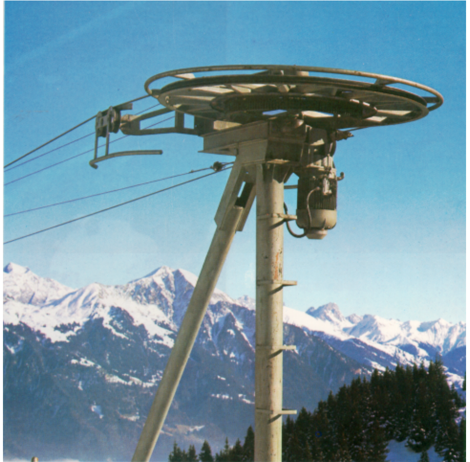
Bild 23.2.3 »Aufstellung im Freien« ist bei einem Skiliftantrieb nicht zu umgehen – die langen Stillstandszeiten sind so kritisch wie die Einwirkung von Schnee, Eis und Regen
