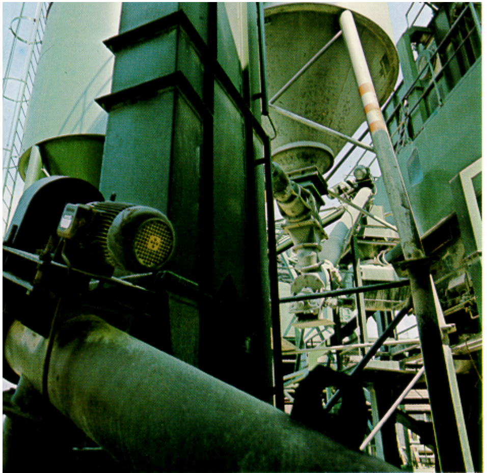
Bild 26.12 Drehstrom-Getriebe-Motoren in einer Makadam- Mischanlage
