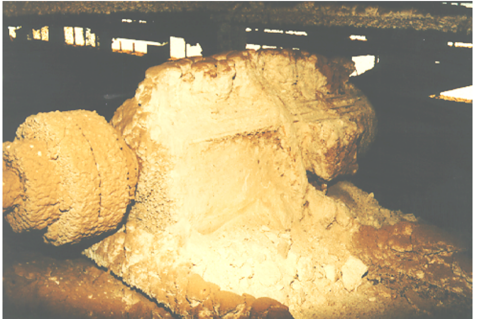
Bild 15.2.2 Getriebemotor mit unzulässig hoher Staubauflage in einer Mälzerei
