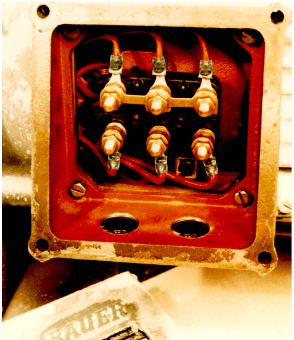
Bild 10.2.2 Klemmenkasten eines Getriebe-Motors in Schutzart IP 65 mit gedichteten Passflächen. Kein Staubschritt!
