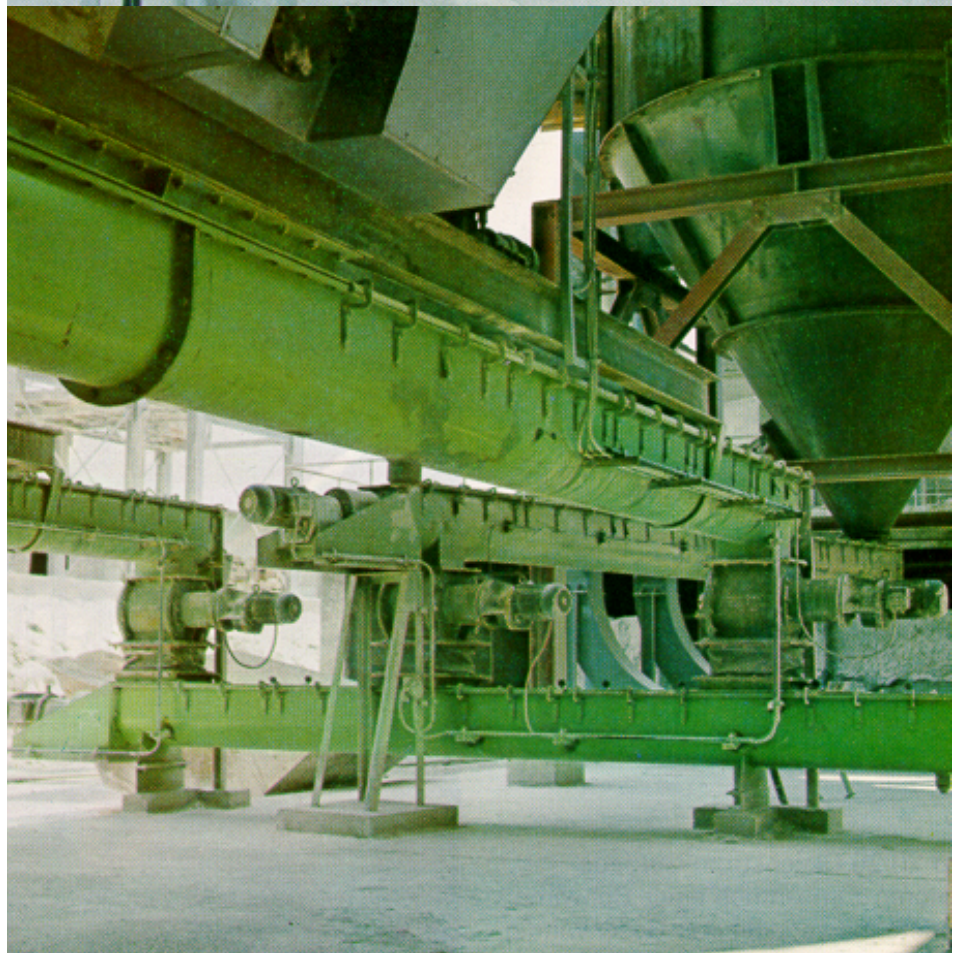
Bild 26.26 Antriebe für Transporteinrichtungen in einem Zementwerk.
