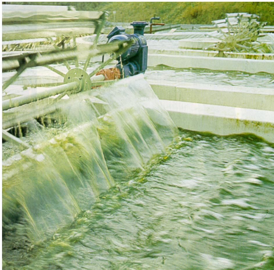
Bild 26.29 Verstell-Getriebe-Motoren zum Antrieb der Belüftungseinrichtung an einem Klärbecken.
